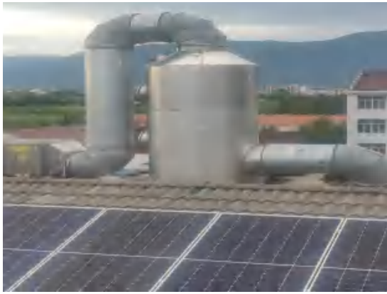
图 3-4-1 油漆废气处理设备
