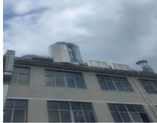
图 3-3 废气处理设备排气筒
