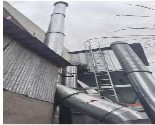
图 3-4-2 打磨废气处理设备
