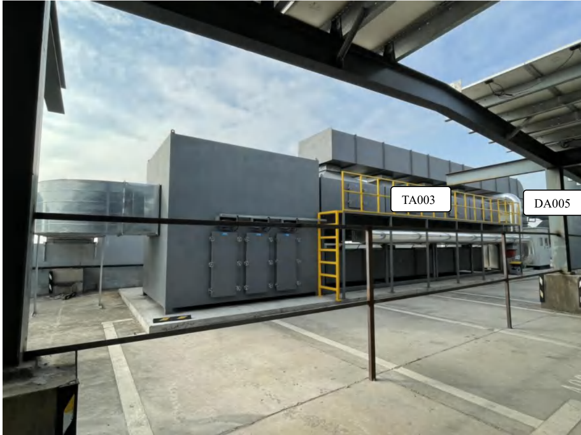
图4-5 胶水废气处理设施图
